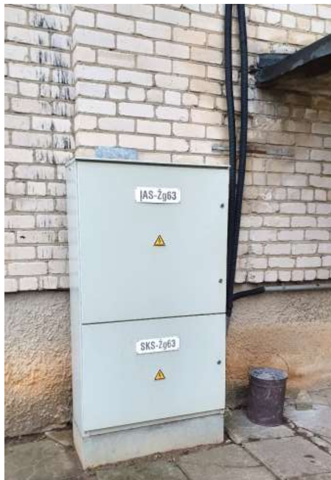
14 pav. Elektros įvadinė spinta lauke
